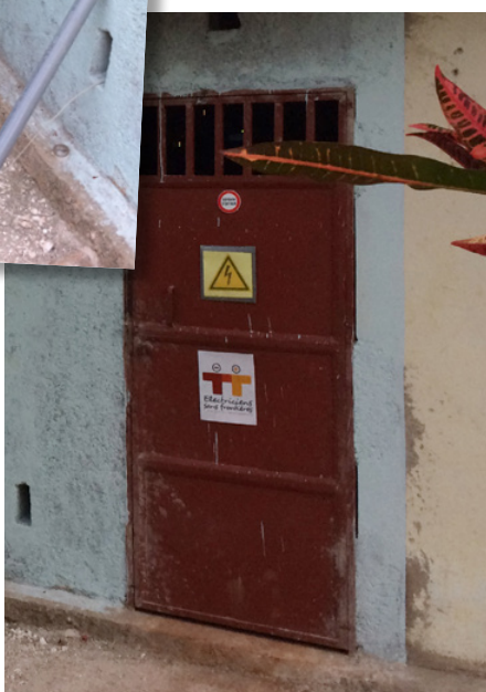
Une fois l'installation en service, la porte du local électrique est fermée à clé par sécurité
