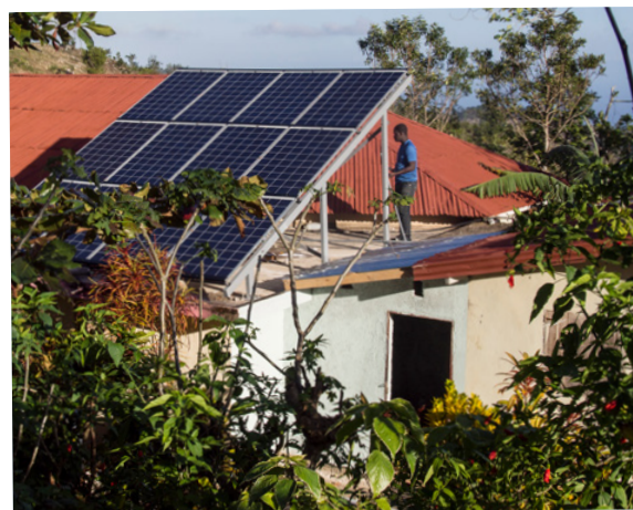
Le raccordement des panneaux est pratiquement terminé, ils sont fixés sur le bâtiment toilettes/douches dont la charpente en béton est très solide. Il reste à poser un entourage pour limiter la prise au vent en cas de cyclone
