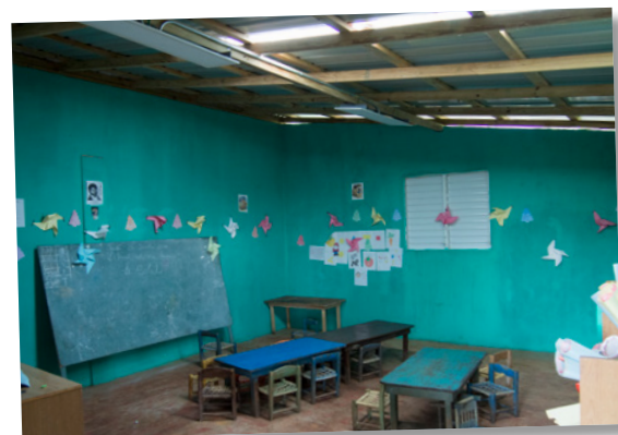
Panneaux d'éclairage posés dans une classe
