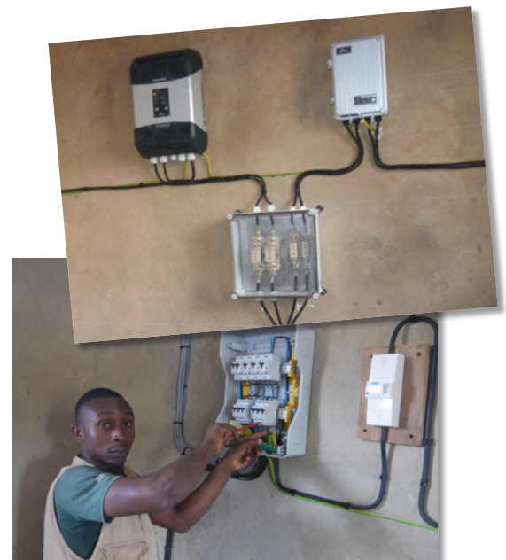
Réglage de l'onduleur et du régulateur
