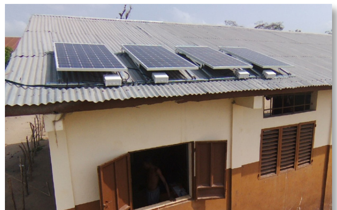
4 panneaux solaires sont maintenant installés sur le toit de l'école
